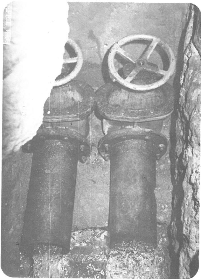
لوله‌های انتقال آب و شیر فلکه دریچه تخت
